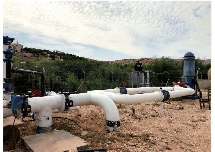
入植者用の地下水を汲み上げる新しい機械
