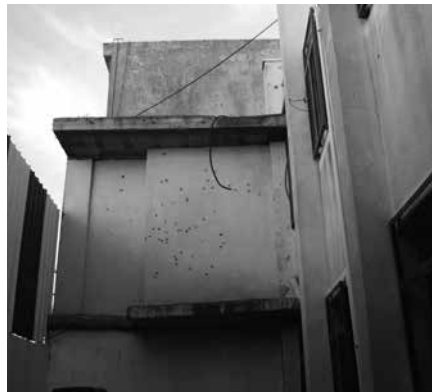
幼稚園内部：イスラエル軍の侵攻（12月2日）による壁の弾痕
