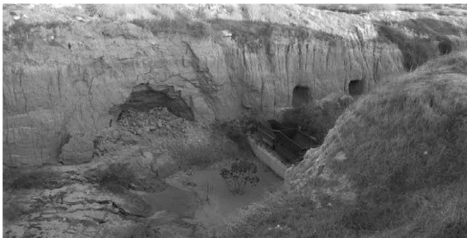
陥没した地下トンネル
