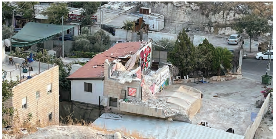
破壊された家（上からの写真）
